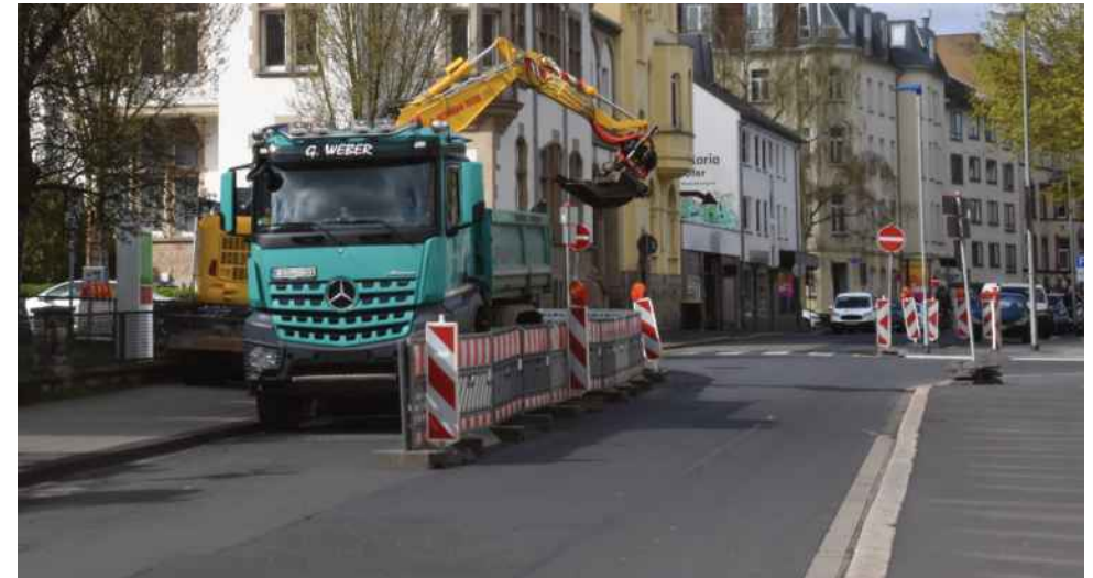
Derzeit ist das Königstor noch eine Baustelle. Anschließend wird die Fahrradstraße eröffnet.
