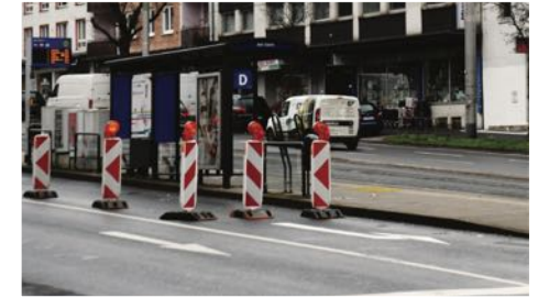
Ausgerechnet dort, wo die Fahrgäste aus der Innenstadt zur Haltestelle strömen, fehlte die Absperrung.
