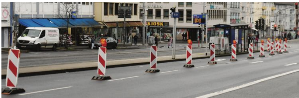
Die ersten Tage des Weihnachtsmarktes fehlte die Verbreiterung der Haltestelle Am Stern komplett. Nach einigen Tagen wurde die linke Spur dann provisorisch mit Verkehrsbaken abgesperrt.
