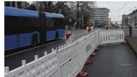
Hier ist gut die Trennwirkung der früheren Absperrung zu sehen. Nur Verkehrsbaken wie in 2025 reichen nicht.
